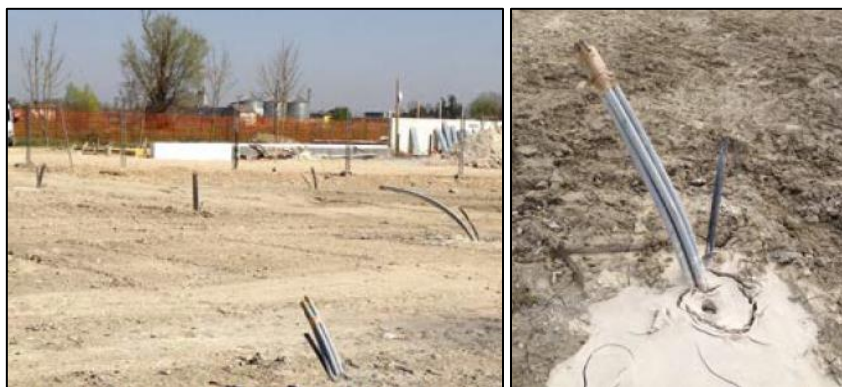
Figura 5: Campo di sonde geotermiche verticali immediatamente dopo il completamento
