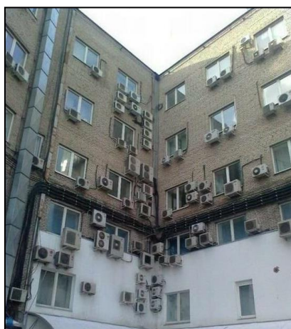
Figura 9: Gli antiestetici gruppi frigo possono essere eliminati con un impianto geotermico
